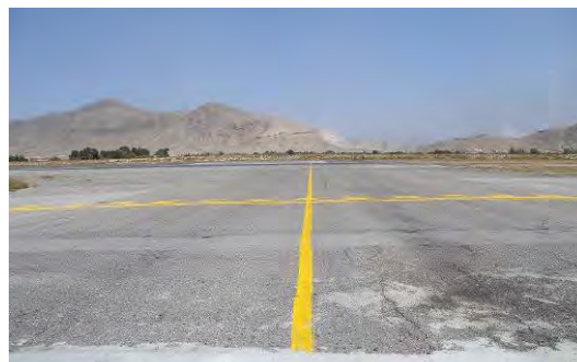
誘導路の劣化状況
