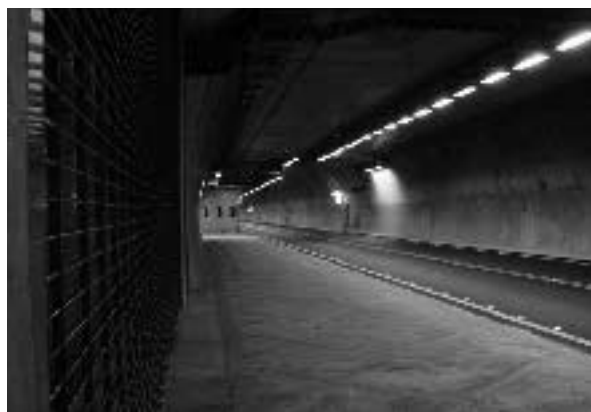
写真-5 雪山トンネル内（高速道路脇の空気循環施設前）
